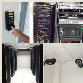
NOC (Sala de Servidores)
